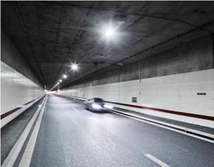
Beleuchtung (Tunnelabschnitt Witi) mit LED Technologie (80 Watt bei 100%). Bestückt mit elektronischem Vorschaltgerät für volle Dimmbarkeit und geringste Verlustleistung. Jede Lichteinheit ist via LON Powerline ansteuerbar
