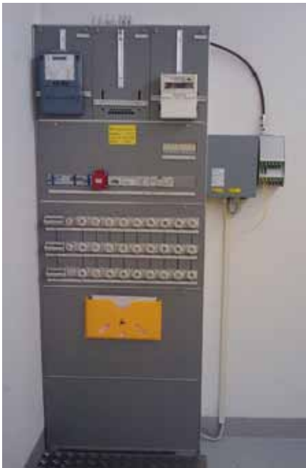
Beispiel einer CH-Trafostation, wo der zentrale Kommunikationsbaustein eingesetzt ist (kleine grau Box).
